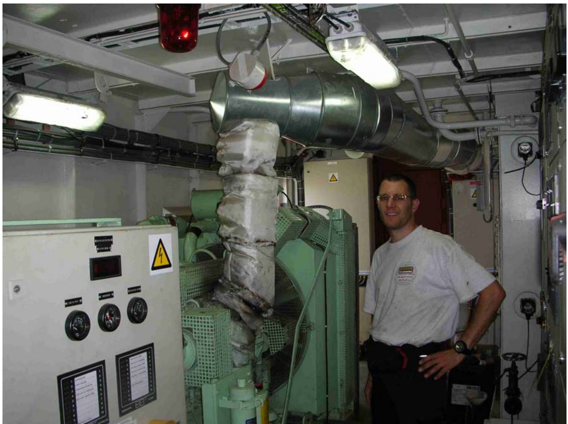
UND BEIM TESTLAUF DES NOTSTROM-GENERATORS
